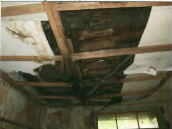
Foto Nr.21. Iebrūkusi 2.stāva grīda
