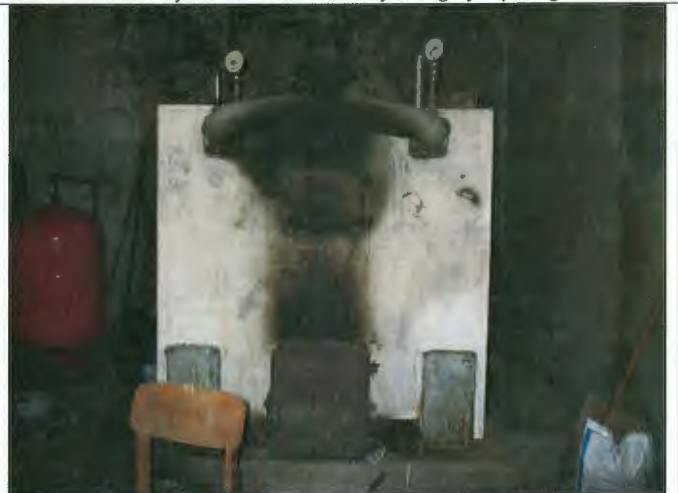
Foto nr.6. Koksnes apkures katls. Netiek ekspluatēts.
