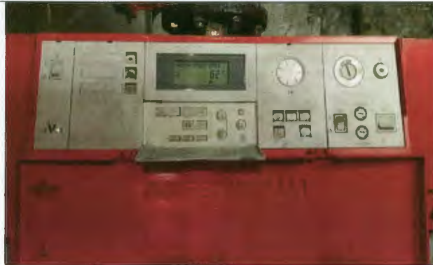
Foto nr.1. Dabaszāzes katla vadības panelis.
