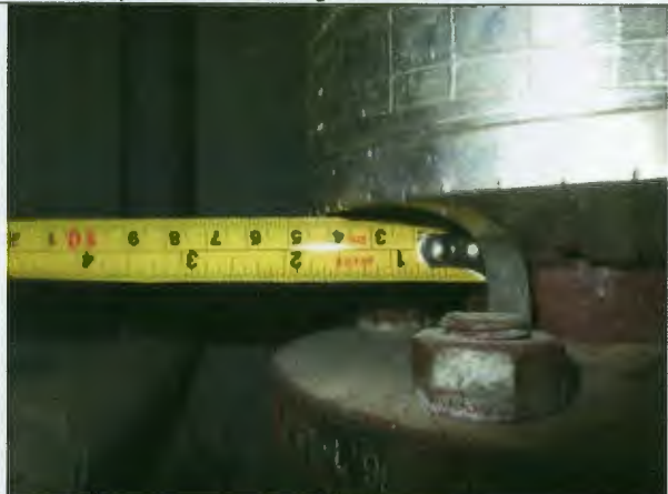
Foto Nr.3. Siltummezgls Ir siltināts ar rūpnieciski ražotām čaulām.
