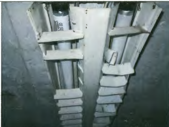
Foto Nr.8. Ēkā apgaismojums pārsvarā tiek nodrošināts ar luminiscences spuldzēm.
