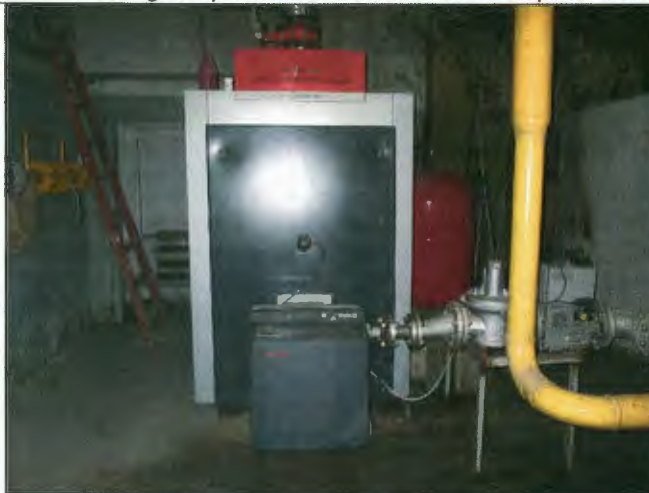
Foto nr.5. Dabaszāzes katla deglis - Max Weishaupt GmbH WG40N/1-A.
