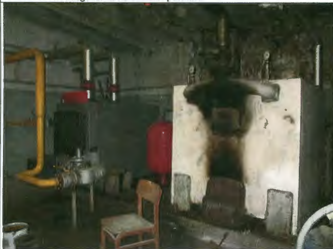
Foto nr.3. Dabaszāzes apkures katls un ar koksni kurināms apkures katls.
